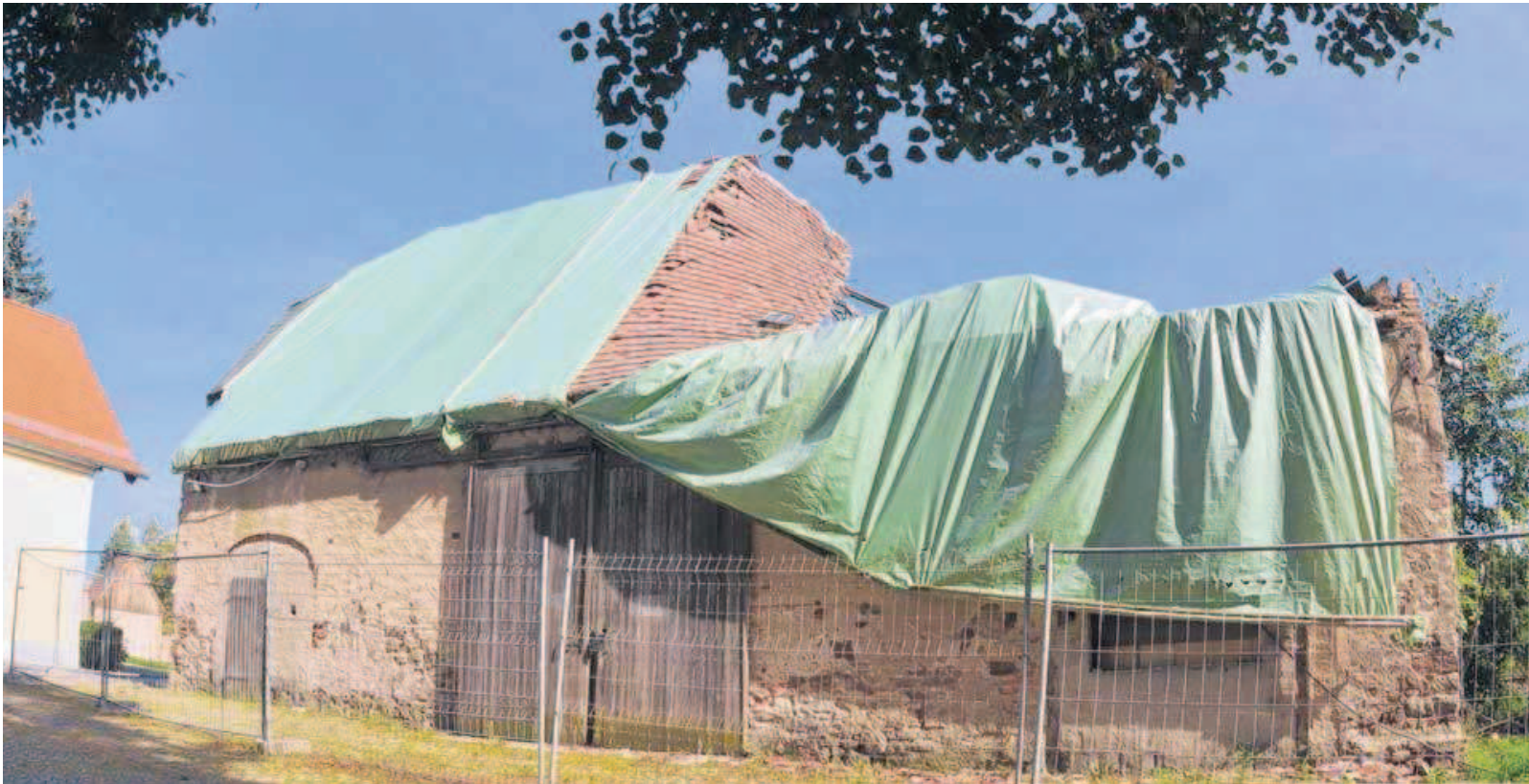
Die Klosterscheune in Sornzig soll nicht länger Bauruine sein. Das Dach ist zum Teil schon eingestürzt. Für das Gebäude stehen jetzt 100 000 Euro Fördermittel aus dem Programm Integrierte ländliche Entwicklung (Ile) in Aussicht. Foto: Sven Bartsch
