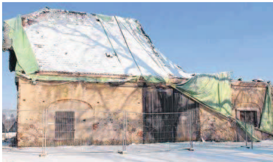
Das Dach der Klosterscheune ist teilweise eingestürzt. Die Planen sollten das Bauwerk vor dem weiteren Verfall schützen. Fotos: Dirk Hunger
