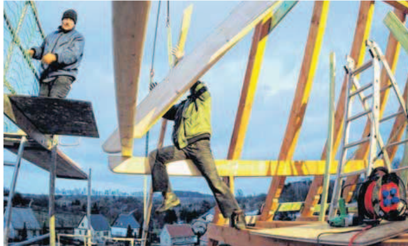
In luftiger Höhe werden die letzten Dachsparren an der Klosterscheune in Sorntzig gesetzt. Foto: Sven Bartsch
